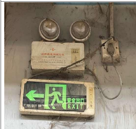
应急灯及安全出口灯
