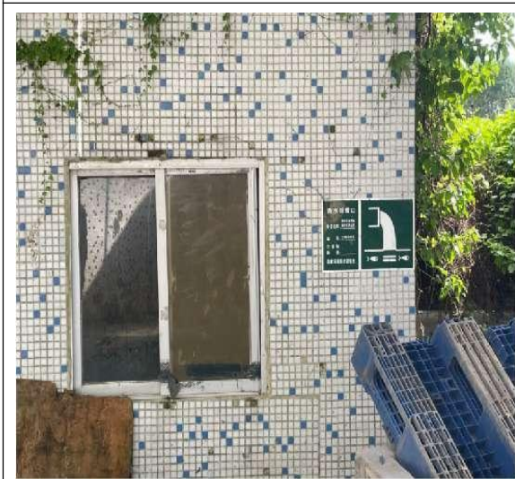
雨水排放口标识牌
