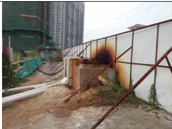
沉砂池 2014年9月28日
