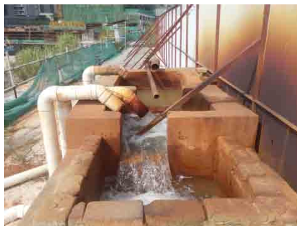
沉砂池 2014年9月28日
