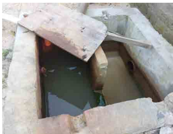
沉砂池 2014年6月28日
