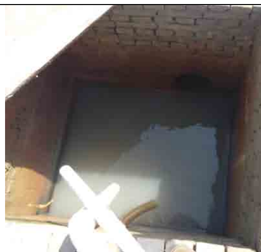
沉砂池，2014 年 2 月 28 日
