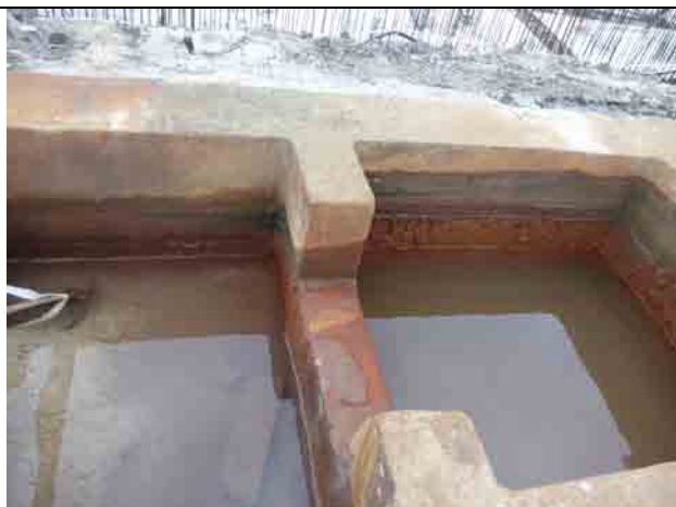
沉砂池 2015年5月28日
