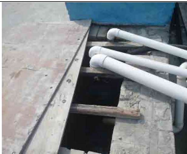
沉砂池 2014 年 9 月 28 日
