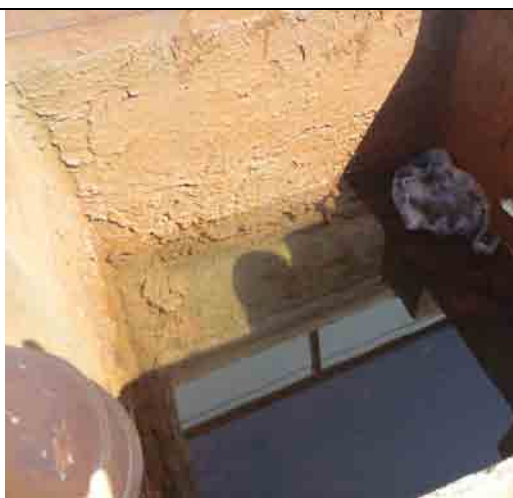
沉砂池，2014 年 2 月 28 日
